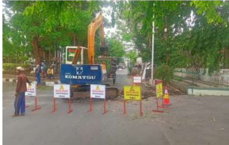
Gambar 4.5 Rambu Pengaman Pekerjaan (Sumber : CV. Progresif Quality Planning, 2023)
