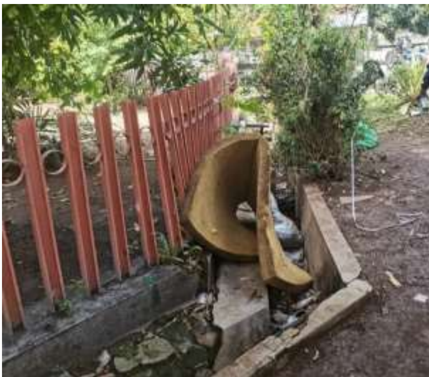
Gambar 4.4. Sampah pada saluran drainase (Sumber : Dokumen CV. Mekar Konsultan, 2023)
