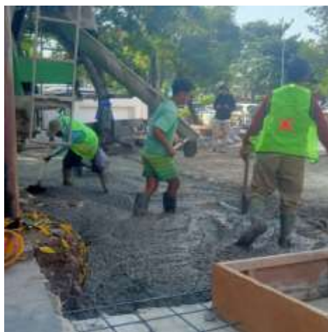
Gambar 4.21 Pekerja menggunakan APD saat pekerjaan cor beton (Sumber : CV. Progresif Quality Planning, 2023)
