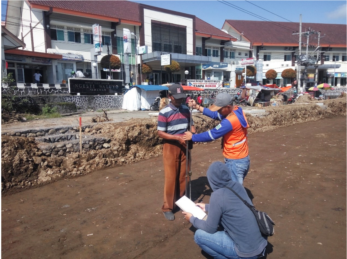
Gambar 1. Petugas pengendali mutu tidak mengenakan APD yang layak
